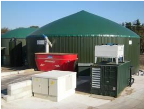
Afbeelding 3.4 Biogasinstallatie in landbouwgebieden
