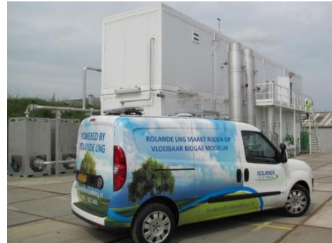
Afbeelding 3.5 Opwerkingsinstallatie voor groen gas van Attero
