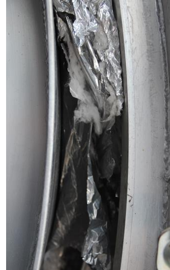
Afbeelding 5.15 Isolatiemateriaal tussen de binnen- en buitentank
