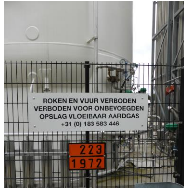
Herkenbaarheid van LNG & contactgegevens exploitant in de nabijheid van opslagtank
