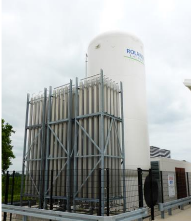
Opslagtanks met vulinstallatie
