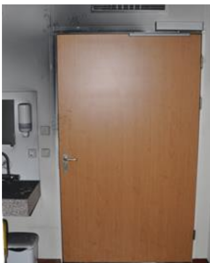
Figuur 5.7 Roetaanslag naast linker bovenzijde van de deur als indicator voor rookverspreiding door het openen van de kamerdeur
