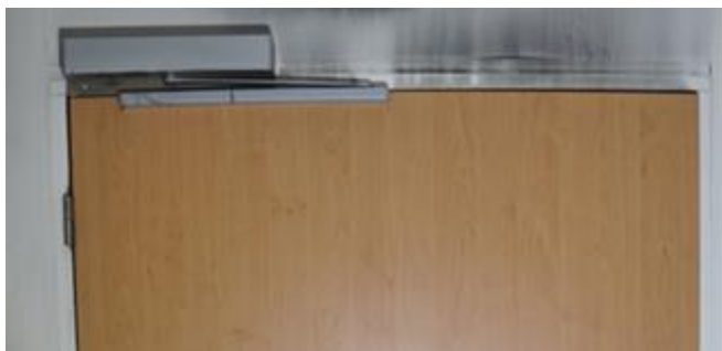
Figuur 5.6 Roetaanslag als indicator voor rookverspreiding via de naad aan de bovenzijde van de deur
