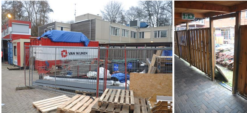
Figuur 6.4 Geblokkeerde vluchtroute achter de nooduitgang van de overdekte looproute
