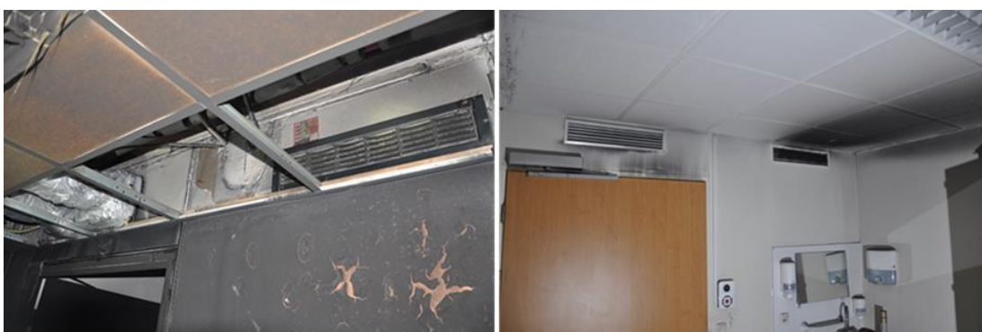
Figuur 5.8 Ventilatie-rooster gezien vanuit de gangzijde en roetaanslag boven het rooster aan de kamerzijde
