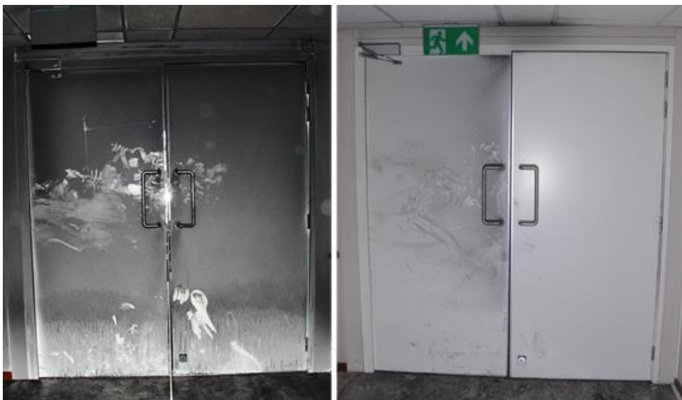
Figuur 5.9 Foto links: de brandzijde, foto rechts: deurconstructie tussen twee brandcompartimenten
