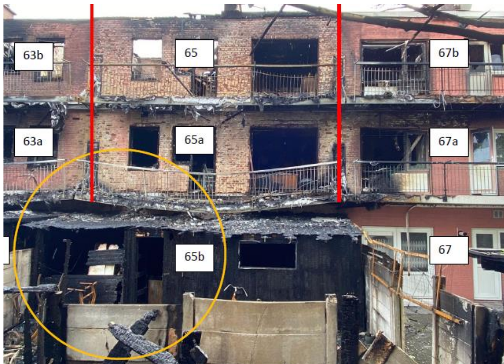
Figuur 4: Foto aanbouw na de brand (bron: rapportage Team Brandonderzoek)
