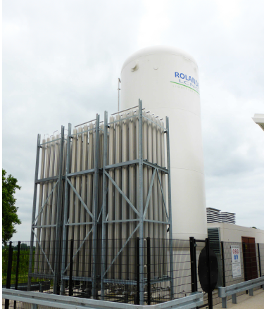
Opslagtank met warmtewisselaar
