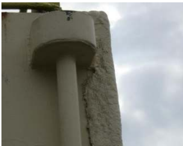
Figuur 40 – Slechte detaillering van een PBB-terminatie
