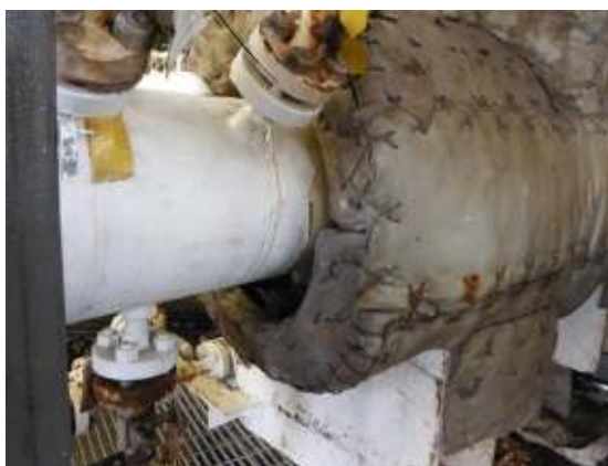
Figuur 25 – Slechte afwerking van een koppelvlak (component is niet aanwezig)
