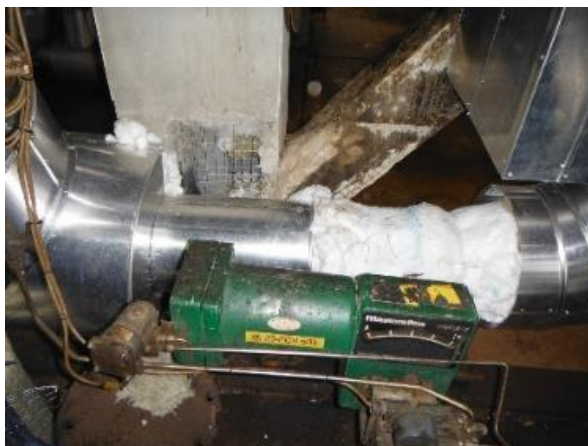
Figuur 26 - Cladding verwijderd maar niet teruggezet
