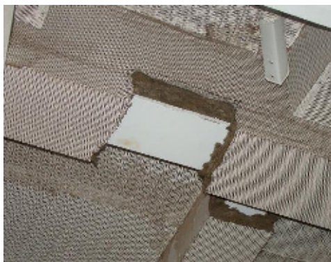
Figuur 22 – Wapeningsgaas retentiesysteem (en isolatie) zijn niet vervangen
