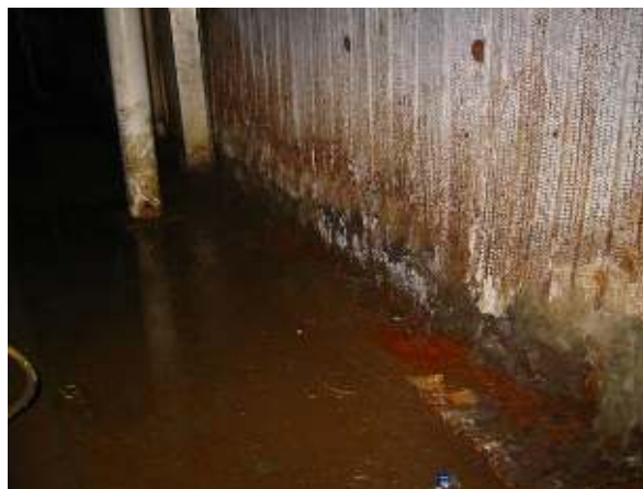
Figuur 19 - Ernstige waterschade aan retentiesysteem van MMMF isolatie (Foto © MMI Engineering Ltd.)
