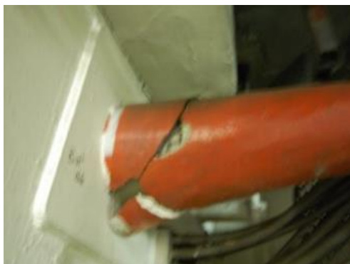
Figuur 32 – Schade aan doorvoering gemaakt van LWC-materiaal
