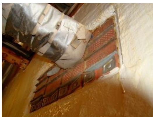
Figuur 33 – Slecht geïsoleerde kabeldoorvoer (Isolatie van de barrière is wel op zijn plaats)
