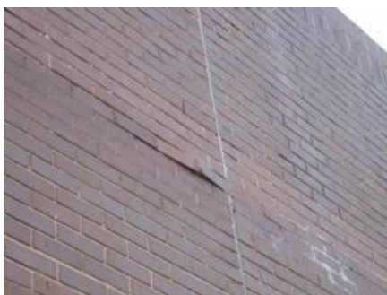
Figuur 28 – Doorbroken metselwerk barrière dat rookdicht en gaslekdicht moet zijn
