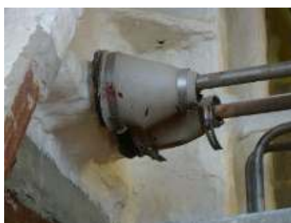
Figuur 30 – Onjuist geïnstalleerde gecertificeerde gaiter-type doorvoeringen met isolerende coating
