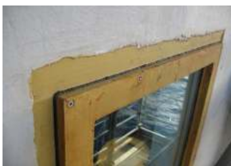
Figuur 34 – Ontbrekende isolatie rondom brandwerende raam met brandklasse
