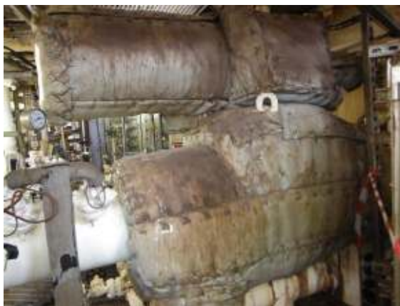
Figuur 18 – Vervuiling aan de buitenste laag van een Dry-Fit systeem
