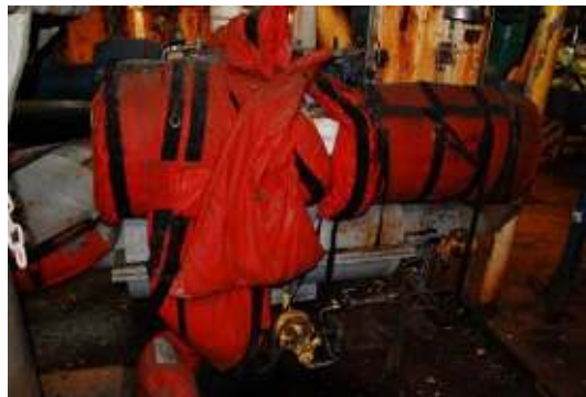
Figuur 21 – Onjuist geïnstalleerd jacket-type dry-fit systeem (banden als installatie hulpmiddelen) (Foto © MMI Engineering Ltd.)
