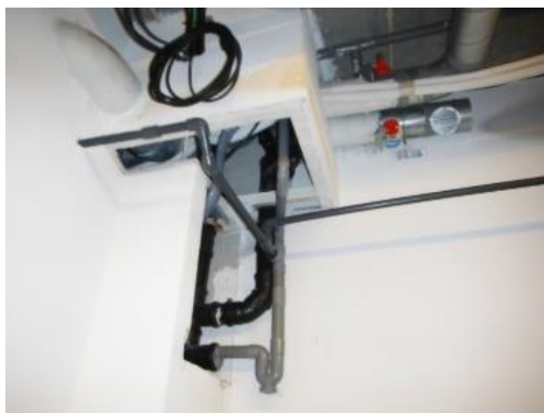
Figuur 31 – Doorvoering niet afgedicht
