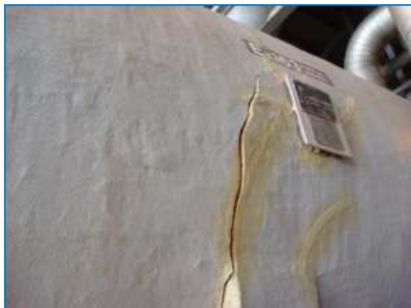
Figuur 13 –Epoxy PBB barst vanwege thermische uitzetting
