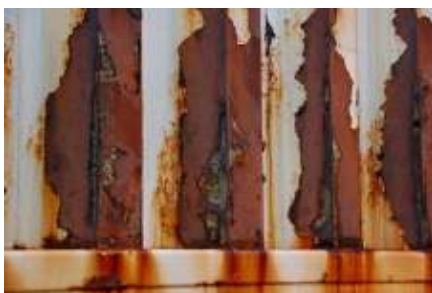
Figuur 27 – Corrosieschade met doorbroken barrière en blootgestelde isolatie
