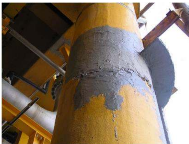
Figure 50 – Slecht uitgevoerde reparatie van een opschuimend epoxy PBB-systeem
