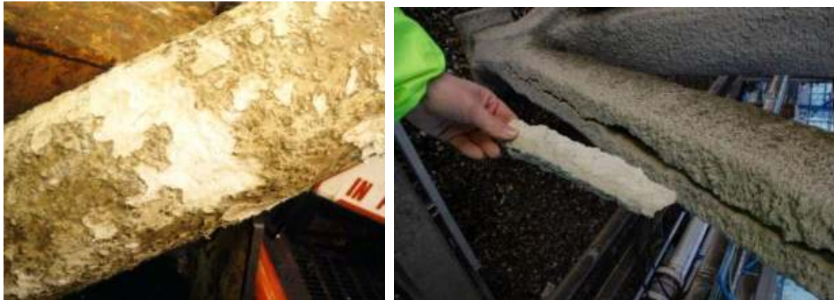
Figuur 10 - Beschadigde LWC-PBB (Foto's © MMI Engineering Ltd)
