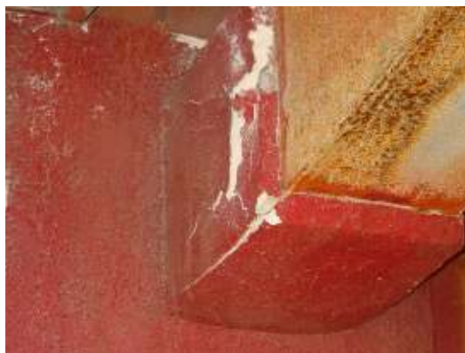
Figuur 35- Beschadigde cementgebonden coating in gebruik op een HVAC-kanaal
