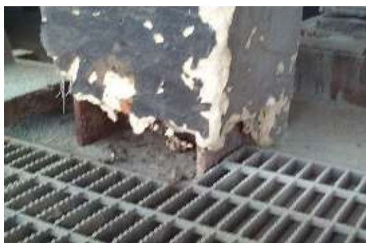
Figuur 47 – Beschadigde coating vanwege wateropname
