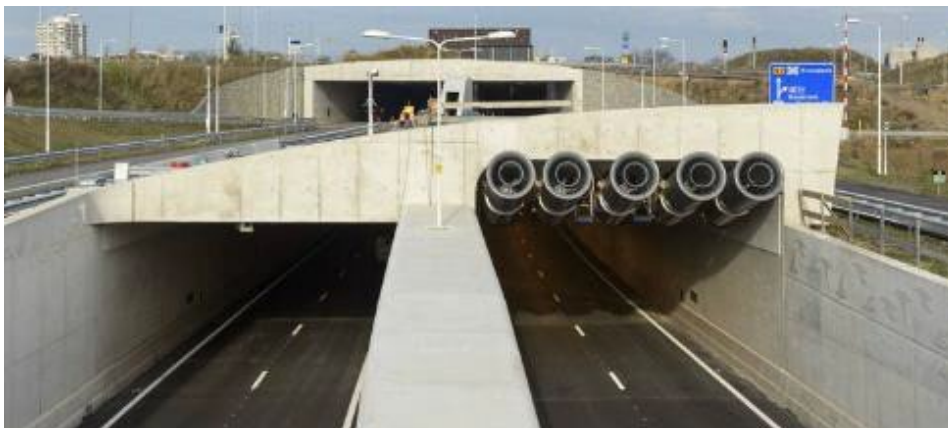
Figuur 7. Ventilatoren in de tunnelmond
