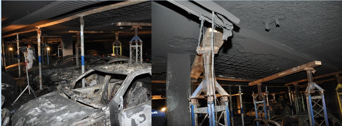
Figuur 4.6 Afspatten betondekking bij brand in een parkeergarage (Bron: IFV)
