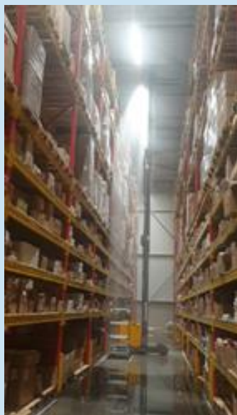
Figuur 5.1 Geactiveerde sprinklerkop in een magazijn (Bron: VGGM)
