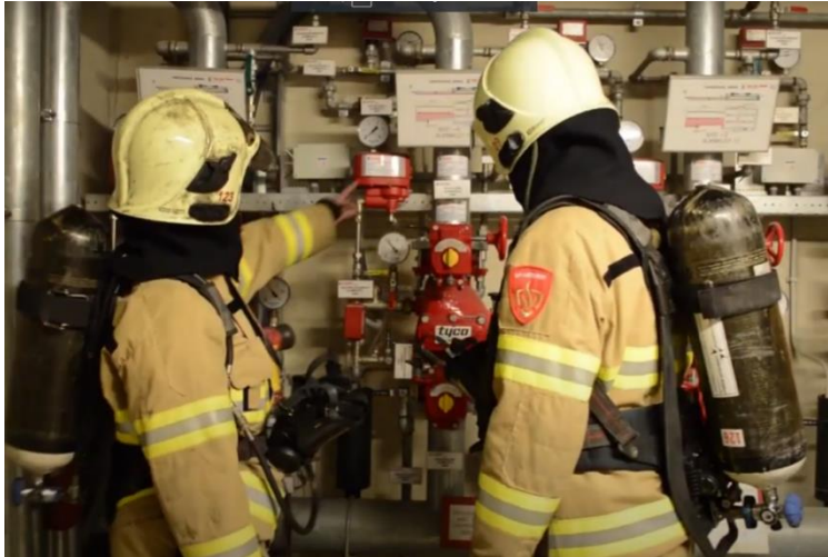
Figuur 4.3 Blusploeg identificeert de geactiveerde sprinklersectie (Bron: TBO VGGM).
