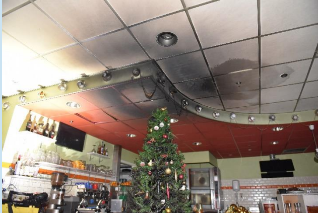
Figuur 1.2 Geactiveerde sprinklerkop nabij de vuurhaard (Bron: TBO VGGM)
