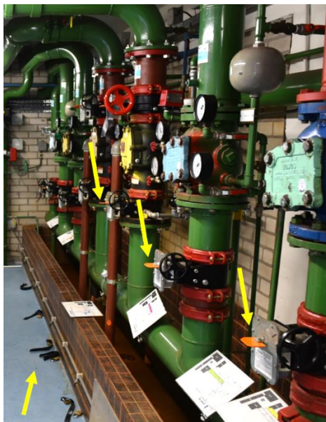
Figuur 4.4 Dichtgedraaide afsluiter van een sprinklerinstallatie; kettingen op de grond, de oranje indicator op afsluiter staat horizontaal (dicht) (Bron: TBO VGGM)
