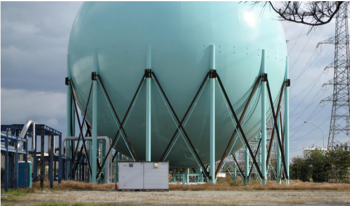
Figuur 13. Additionele riemen om de steunpilaren van een bolvormige opslagtank te versterken tegen aardbevingen (Foto: E. Krausmann)
