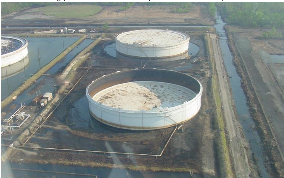
Figuur 9. Verschoven atmosferische opslagtank en ander stormvloedschade als gevolg van een orkaan, inclusief verschoven leiding (Bron: NOAA Office of Response and Restoration)
