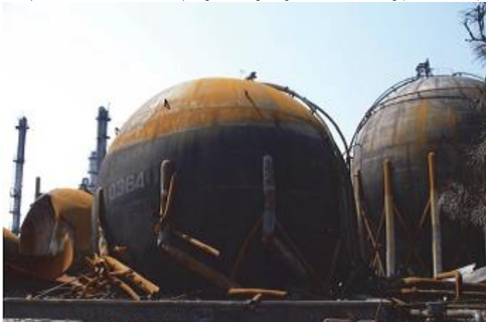
Figuur 7. Steunpoot falen van een sferisch opslagvat als gevolg van een aardbeving (Foto: H. Nishi)
